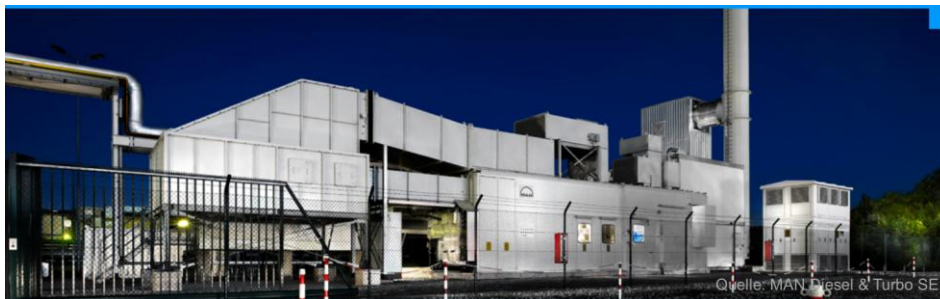
neue KWK-Anlage bei Solvay/Solvin in Rheinberg
